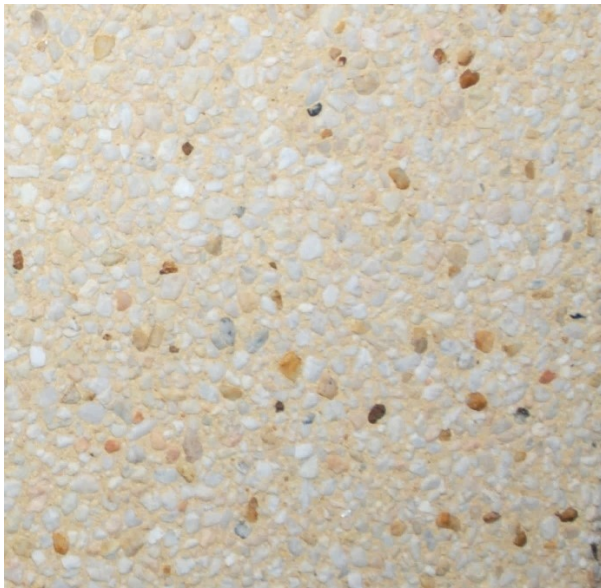
Abbildung 5.12: Beispiel für feingewaschene, eingefärbte Sichtbetonoberfläche
