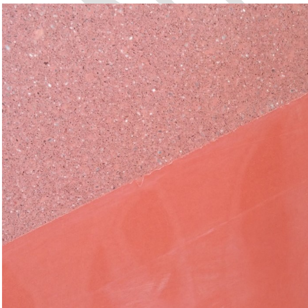
Abbildung 5.10: Beispiel für gesäuerte Sichtbetonoberfläche (oben) im Vergleich zur schalungsglaten Ausführung (unten)
